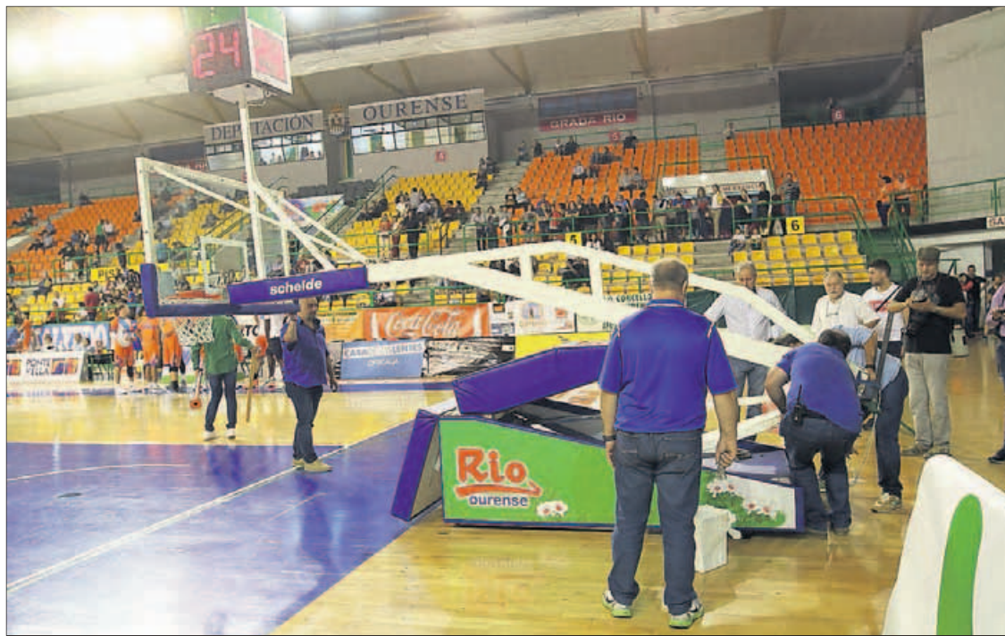
Los operarios del Pazo Paco Paz tratan de arreglar el soporte hidráulico de la canasta. // Iñaki Osorio
